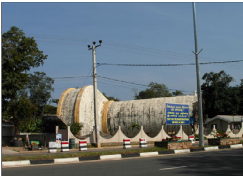
Zdjęcie 4. Zniszczona wieża wodna w Kilinochchi
