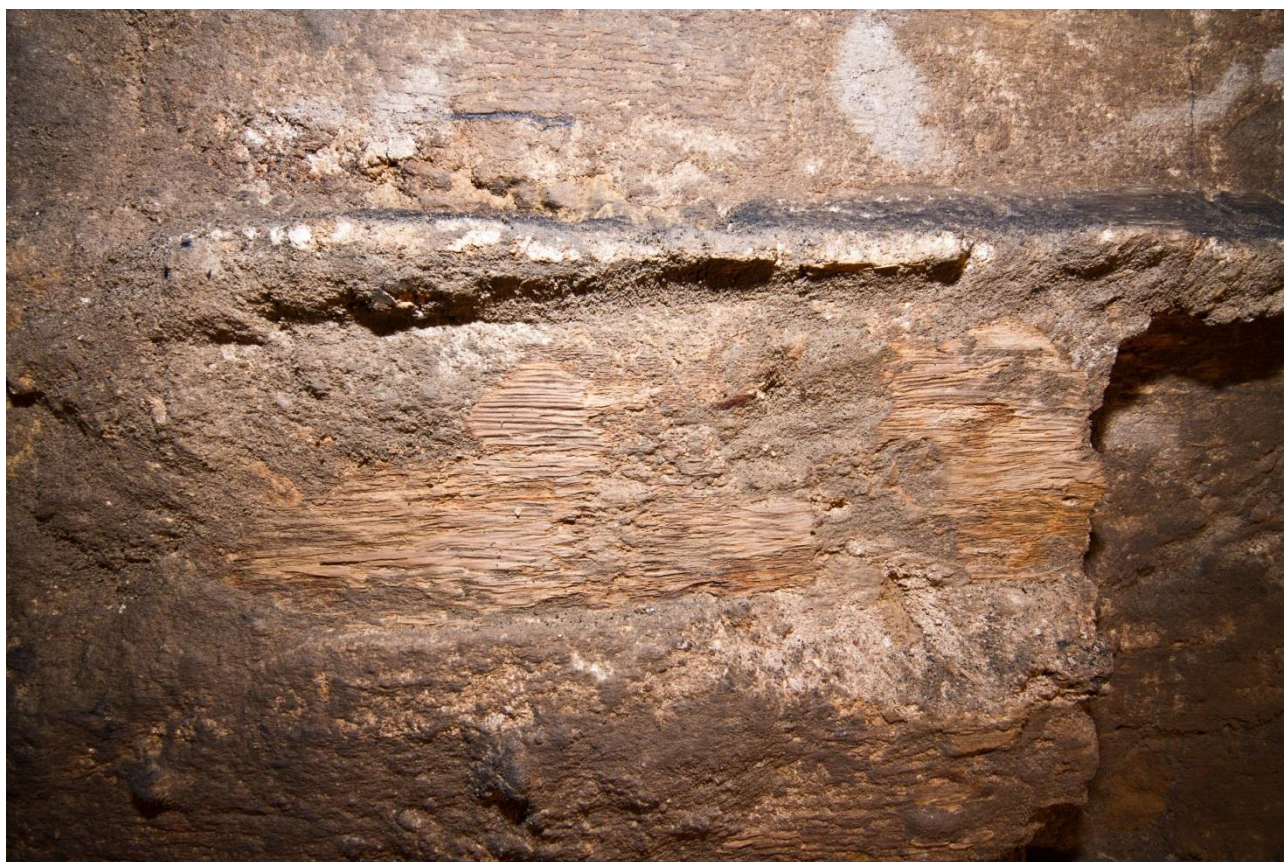
Ryc. 29 - Siewierz. Ściana wschodnia - zachowane ślady po szalunkach Fot. A. Ginter
