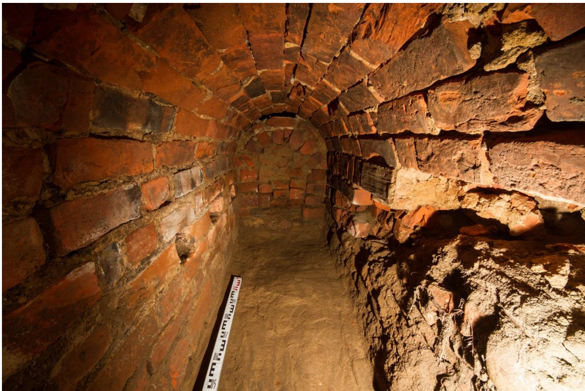
Ryc. 165 - Biała Rawska. Wnętrze krypty numer 2 po oczyszczeniu. Po prawej stronie zdjęcia widoczne ubytki w licu, wymagające podjęcia działań o charakterze konserwatorskim. Fot. A. Ginter
