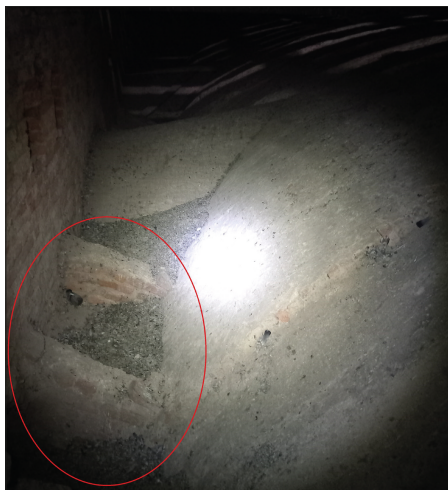
8. Łuków, kościół pobernardyński, sklepienie nawy od strony poddasza. Zaznaczono wzmocnienia sklepienia, fot. autor, 2024
