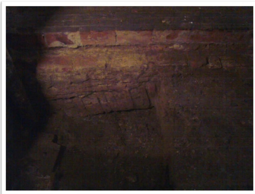
Ryc.6.43 Fundament łukowy umieszczony pomiędzy filarami odsłonięty po zapadnięciu się fragmentu posadzki w Bastionie Furta Wodna. Widok od W (fot. Monika Kasprzak)
