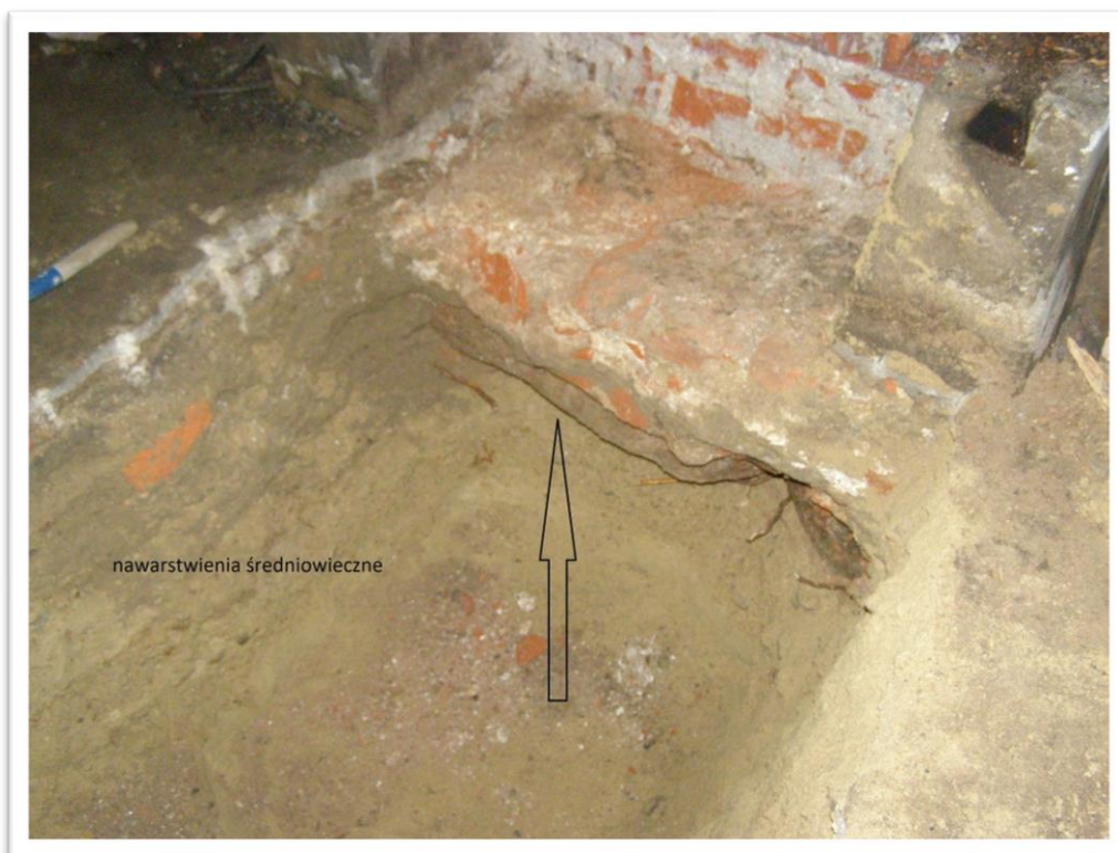
Ryc.2.12 Mur 1 w sondażu 2. Strzałką oznaczono spąg fundamentu. Powyżej nie skuta część muru z oryginalnym licem. Widok od SW (fot. i oprac. M. Kasprzak)
