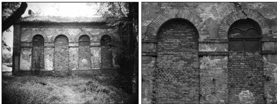
Dom przedpogrzebowy starego cmentarza w Cieszynie. Spękania na północnej ścianie budynku. Fot. Anna Majewska
