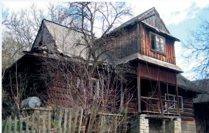
Fot. 3. Niszcząca zabudowa drewniana na terenie Istebnej (aut. M. Dej)
