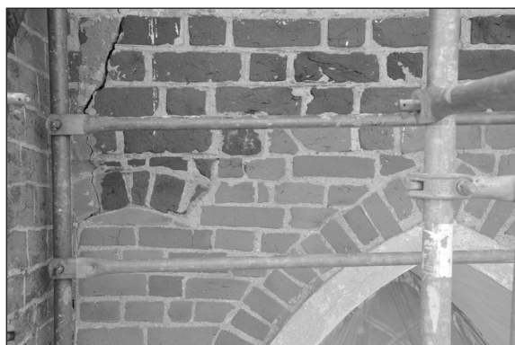
Ryc. 20. Szadek, płn. elewacja korpusu, trzecie przeszło od wsch. Ostrołukowe zamknięcie istniejącego okna wykonane z cegły maszynowej. Po lewej, tuż przy zach. elewacji kaplicy, cztery cegły ostrołukowego zamknięcia okna kościoła halowego. Ta sama substancja w górnej części muru
